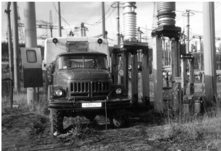
Мобильная генераторная группа ЭРС-67 на площадке ЛЭП при проведении экспериментов по генерации сигналов КНЧ, проводимых в НИР "Ливадия". Кольский полуостров. 2000 г.
